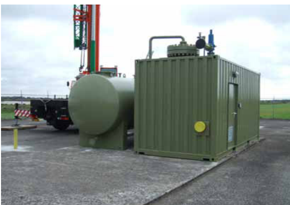
Figuur 5 Voorbeeld van een skid met daarnaast een bovengrondse tank
